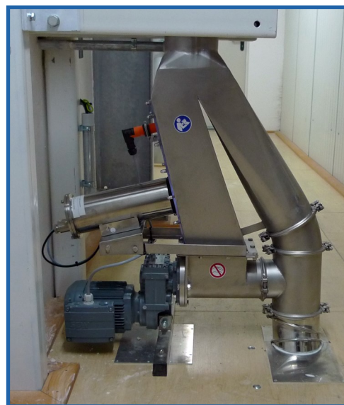
Bypass mit Kamera
